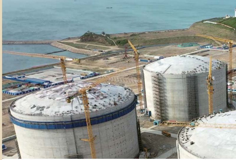
▲ Longkou Nanshan LNG Terminal Project - Phase I
